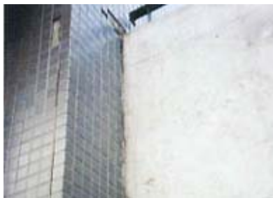
2棟目と3棟目の取り付け部位分(階段)の亀裂。揺れの周期が異なったため引張られたと思われる。
