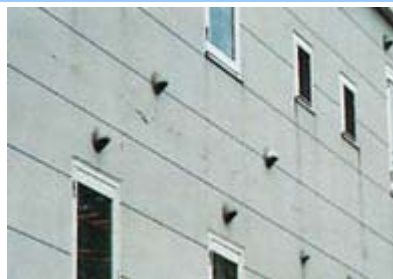
外壁材が所々破損している。
